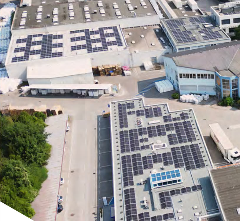
Photovoltaikanlagen am Standort Kremsmünster
