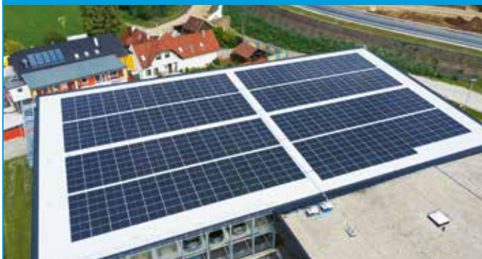
Photovoltaikanlage am Dach der Parkgarage des Greiner Campus in Kremsmünster.
